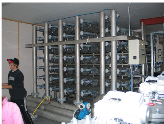
Membranfilteranlegget i vår kommune
